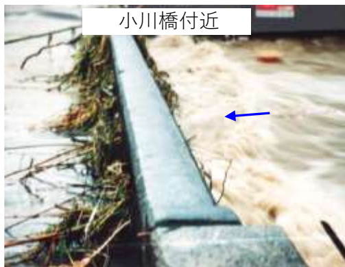
西小川商店街の被災状況
