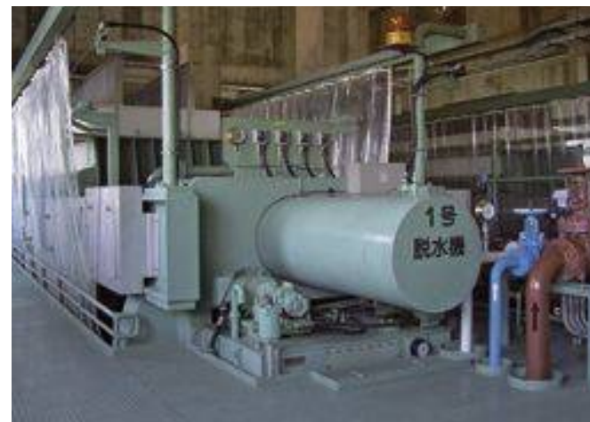
加圧脱水機(汚泥処理設備)
