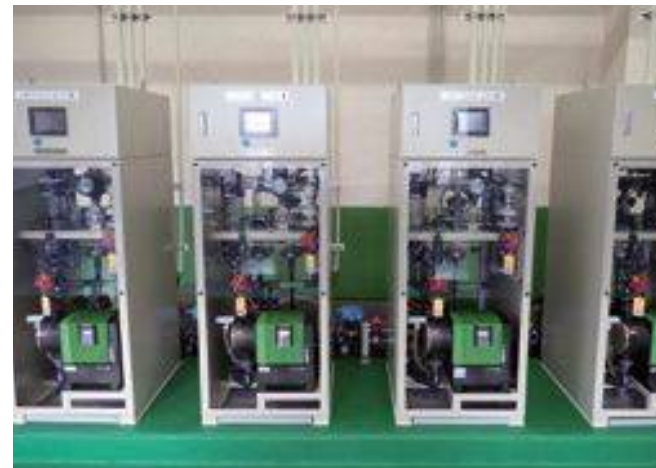
薬品注入ポンプ
