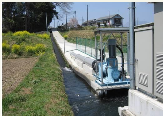
城原井路小水力発電所(竹田市)
