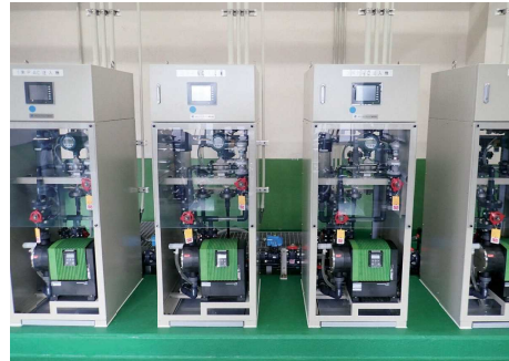
薬品注入ポンプ
