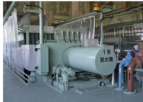
加圧脱水機(汚泥処理設備)
