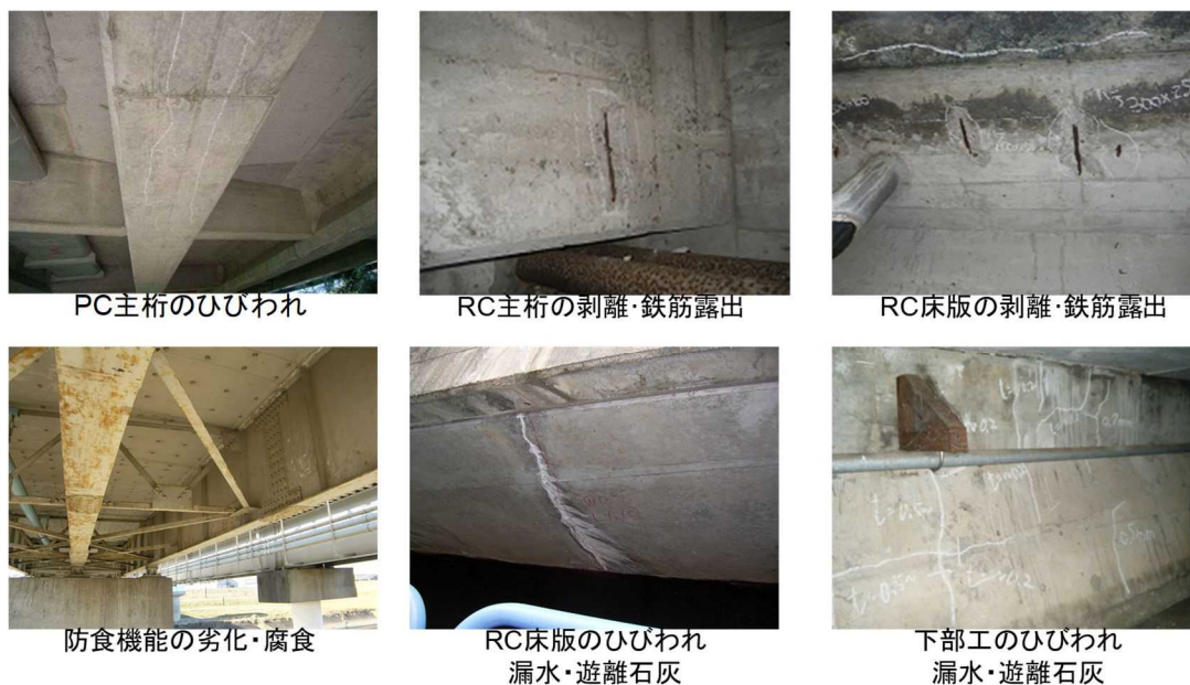
図 13 主な損傷の事例
