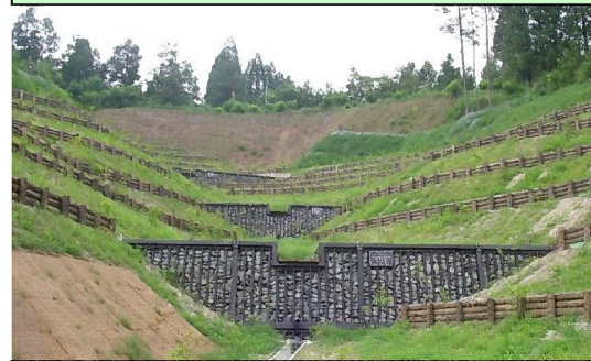
崩れた斜面を森林に戻すための土留工や緑化工（りよくかこう）
