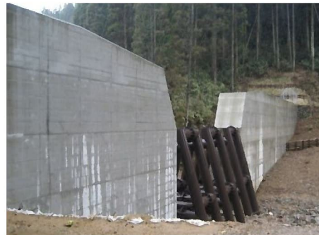
流木を食い止める治山ダム工
