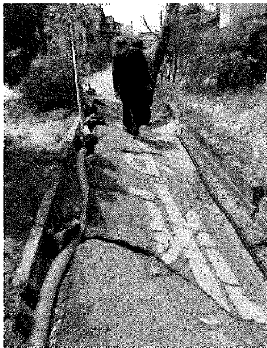
内灘町液状化現象
