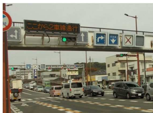
交通管制システム（中央線変移装置）
