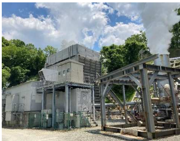
隣地にて稼働中の地熱発電所1号機
