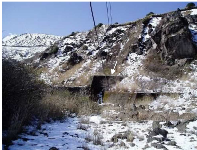
図 3.13 白水川第2号堰堤を下流より望む（引込ケーブルが垂れ下がっている）
