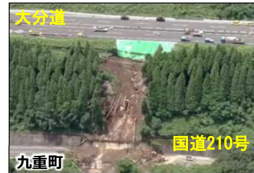
▲令和2年7月豪雨での被災状況
