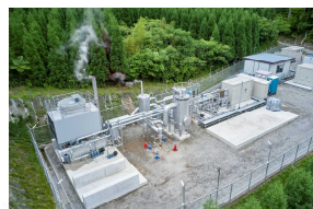
大分県産グリーン水素製造実証プラント@大林組
