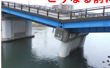
洗堀により橋脚が沈下した橋梁
