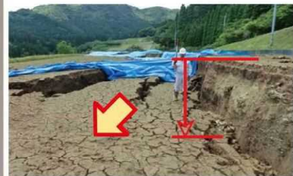
農地の被災状況
