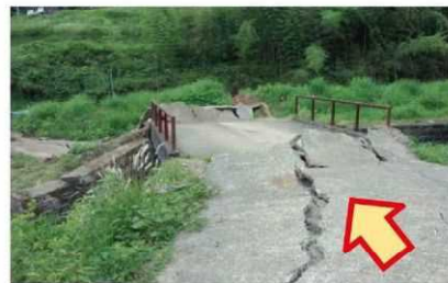
市道橋の被災状況
