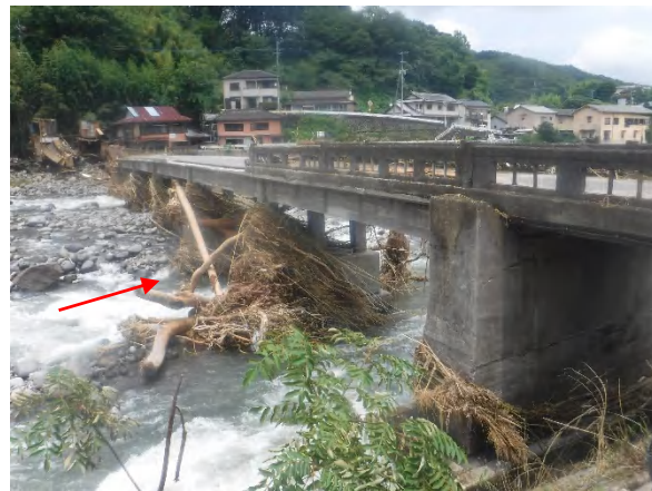
写真 2.1.2 大分川(庄内地区)の被害状況 (令和 2 年 7 月)
