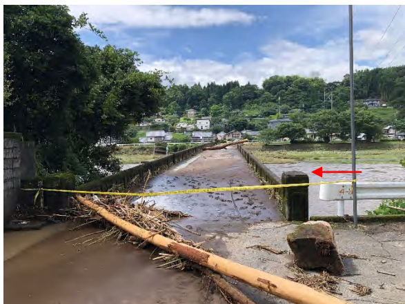
写真 2.1.1 大分川(挾間地区)の被害状況 (令和 2 年 7 月)
