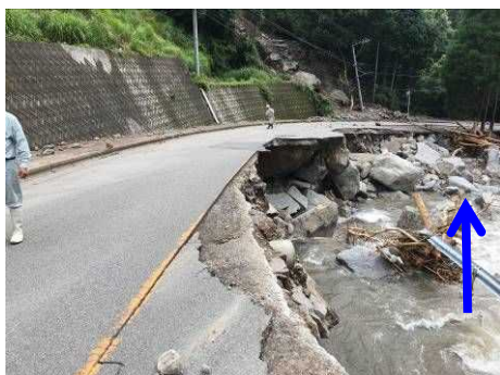
⑧被災状況 R2. 7. 7
