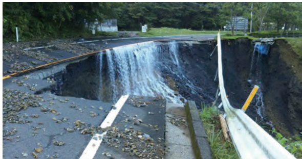
平成29年台風第18号の被災状況
