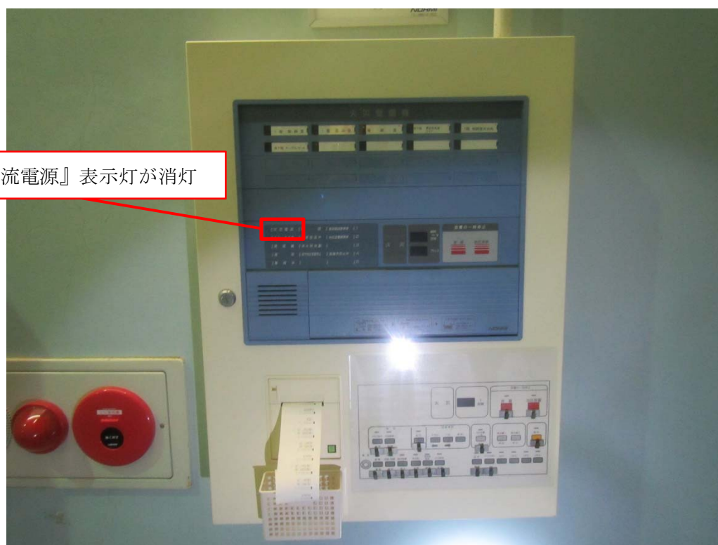
伊方3号機 純水装置建屋内 火災受信機盤（発生時）
