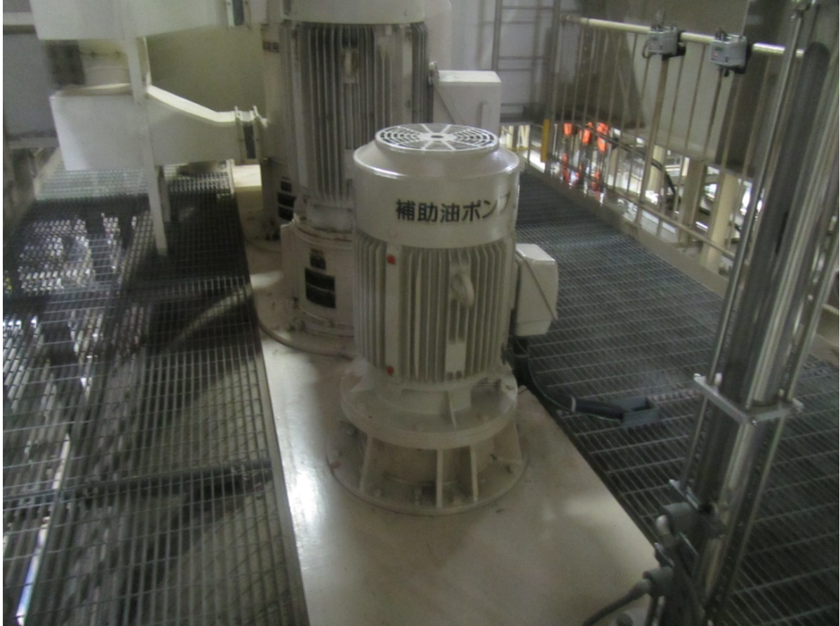
3号タービン建屋 主タービン関係の油ポンプ (この場所付近で体調不良を訴え、中央制御室に戻った)
