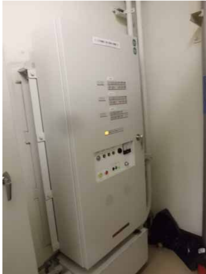
非常用ディーゼル発電機 3 A 二酸化炭素消火設備盤
