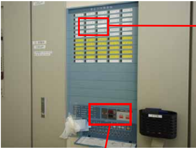
3号中央制御室受信盤
