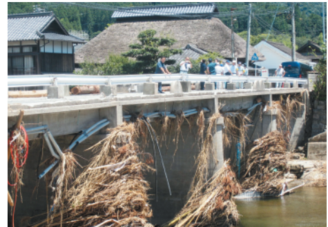
山国川の被災状況を調査
