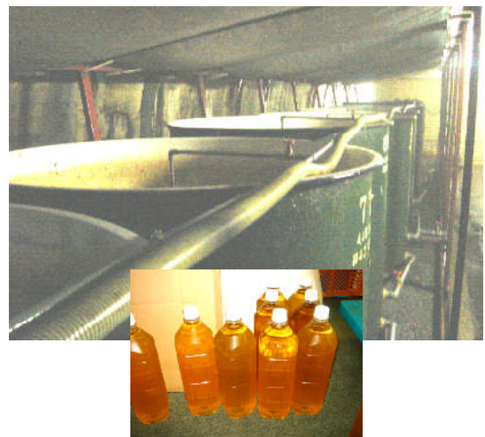
写真1 豚汚水処理施設の概要と処理水（自然浄化方式）
