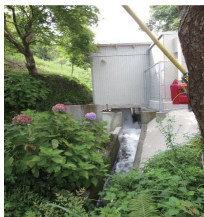
緒方井路小水力発電所（豊後大野市）
