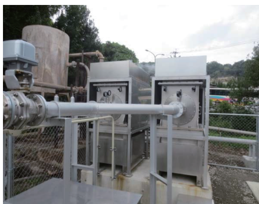
湯けむり発電システム（別府市）
