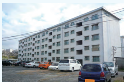
老朽化が進行した県営住宅
