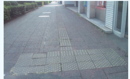
損傷が激しい歩道 (国道197号：大分市都町付近)
