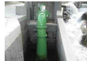
農業用水路に設置した小水力発電機
