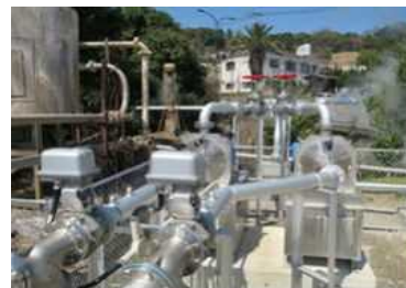
県農業試験施設に設置した湯けむり発電機
